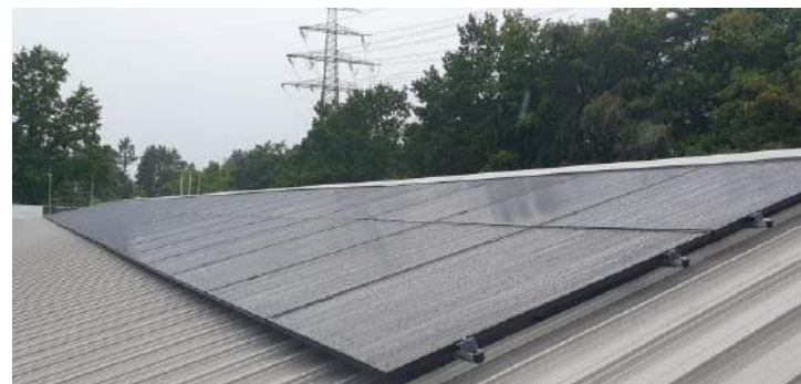
PV-Stromerzeugungsanlage Quelle: SC Wentorf
